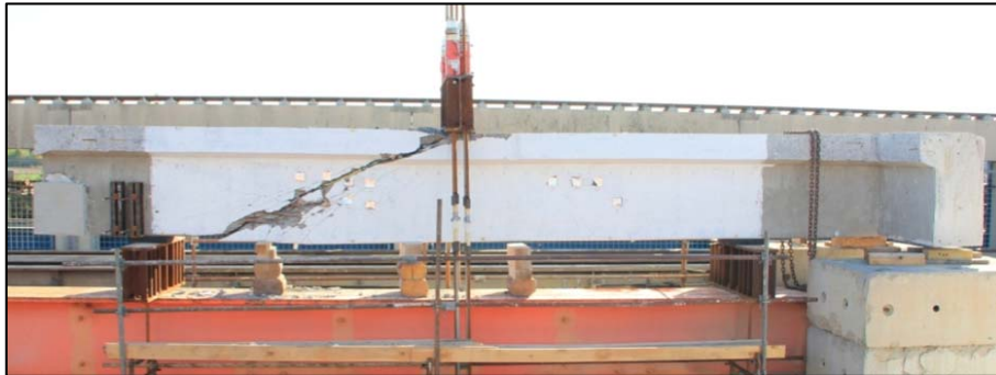
Abb. 2 : Träger nach dem Bruch (Hauptversuch)
